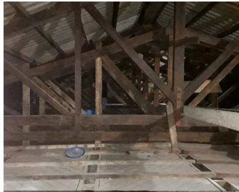
Troca das telhas em toda extensão do templo: nave principal e anexos (mezanino).
